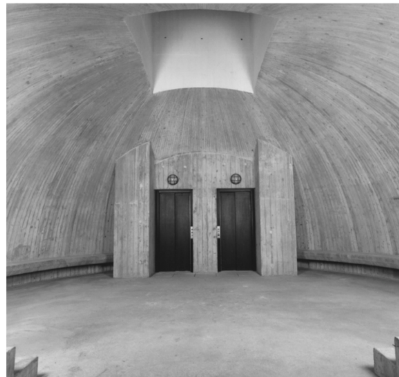
Fig.4 - Sbarco inferiore degli ascensori, alla quota di Piazza del Sole.
